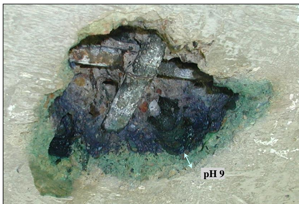
Preparat „Rainbow - Test” – pomiar stopnia karbonatyzacji (pH) betonu w miejscu odkuwki – przykład wyraźnego frontu karbonatyzacji przy pH 9 betonu (kolor zielony)
